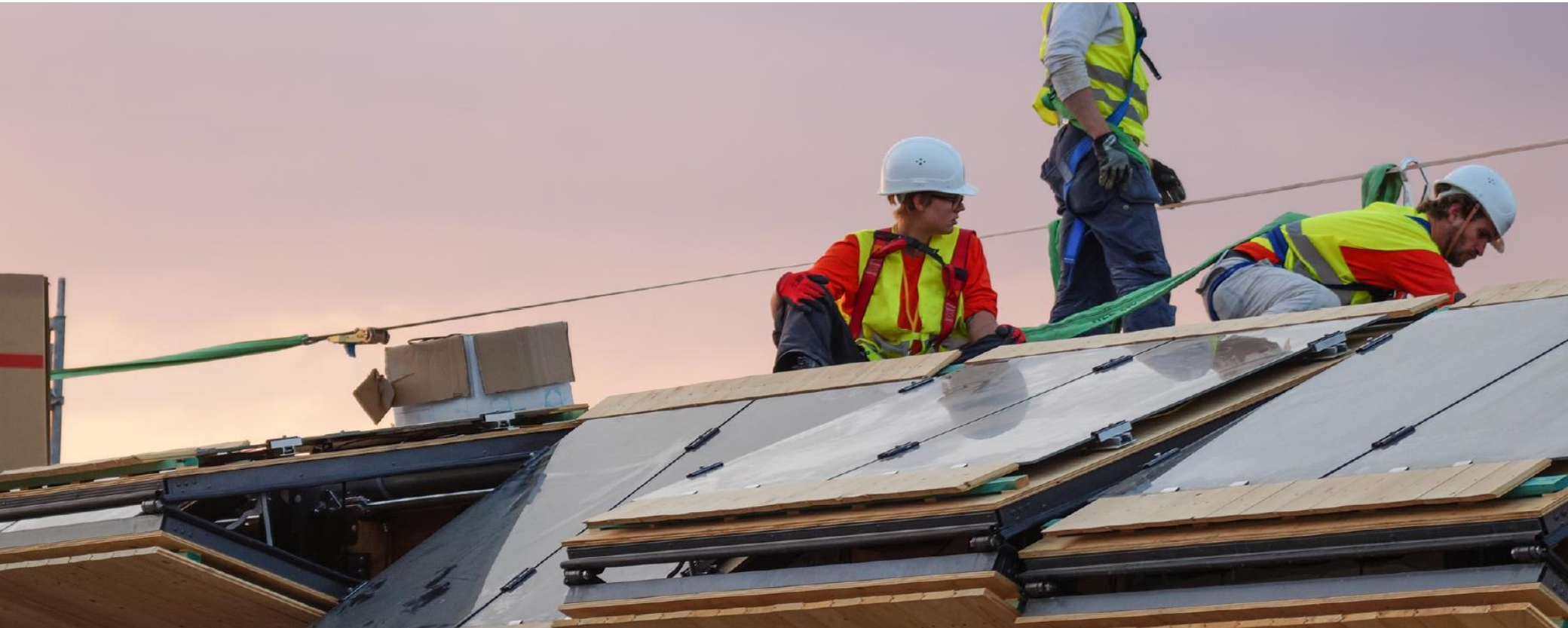
Montage der beweglichen Fotovoltaik-Fassaden beim Rooftop-Gebäude während des SDE 2014 (Quelle: Team Rooftop)
